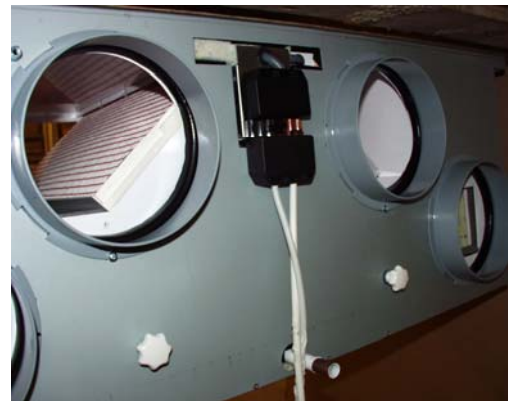
Kuva 2. Sähkösyötön sijainti koneen takana.
